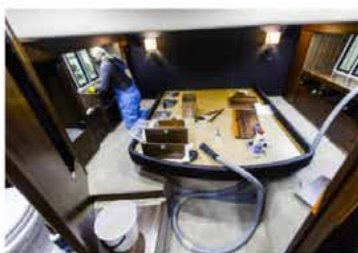
Ägarhytten ligger under salongen och sträcker sig över hela båtbredden. Fönster ger naturligt ljus.
